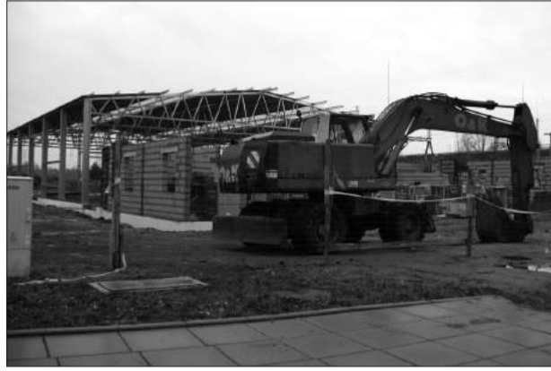
Stalim to kolejna firma, która zainwestowała w specjalnej strefie ekonomicznej na terenach pohutniczych. Na końcu ul. Bojemskiego na Mirowie buduje halę produkcyjną i budynek socjalno-biurowy.
