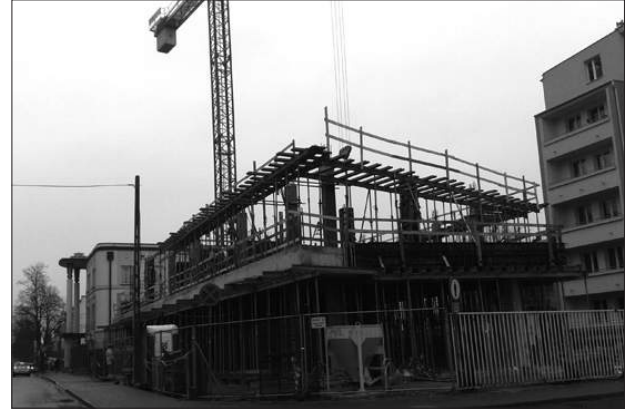
Przy ul. Raclawickiej (w pobliżu ul. Żwirki i Wigury) powstaje nowy, pięciokondygnacyjny biurowiec. Jak zapowiada inwestor, Mirosław Mrowiec, budynek ma być ukończony we wrześniu.
