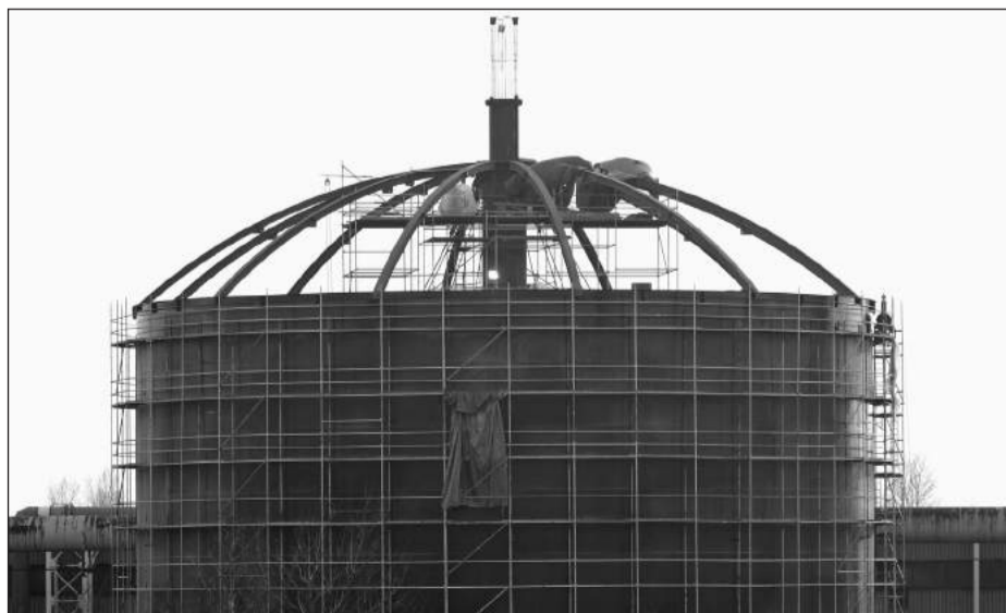
Objętość nowego zbiornika gazu koksowniczego to 12 610 metrów sześciennych.
