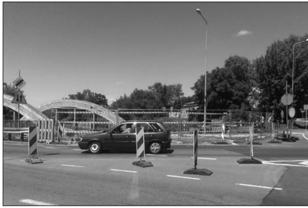
Rozpoczęła się budowa nowego mostu nad Kucelinką w ciągu ulicy Legionów. Zastąpi obecną konstrukcję, która nie nadawała się już do remontu. Most ma być gotowy do końca października.
