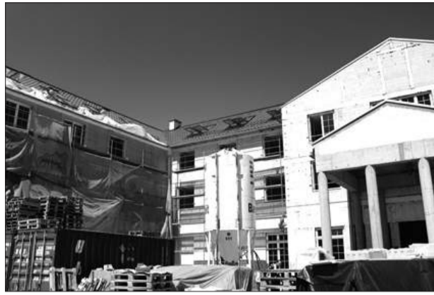
Grupa Arche, która buduje czterogwiazdkowy hotel przy ul. Oleńki, zapowiada, że zostanie on oddany do użytku przed końcem roku. Hotel będzie miał w ofercie ponad 120 pokoi i apartamentów.
