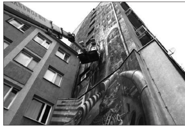
Odnawiany jest mural „Wieża Babel” wykonany według projektu Tomasza Sętowskiego na ścianie bloku przy ul. Dąbrowskiego 1. Malowidło ucierpiało z powodu warunków atmosferycznych.
