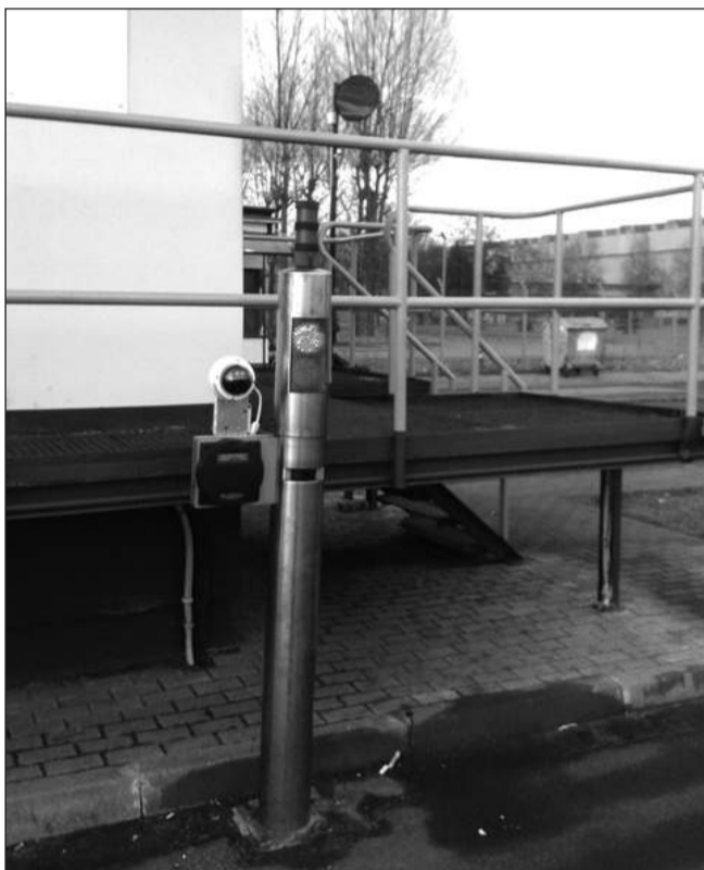
Czytniki dostępu i towarzyszące im kamery zamontowane są przy wszystkich wejściach na teren ISD Huty Częstochowa: w Walcowni Blach Grubych, Stalowni i budynku Zarządu przy ul. Kucelińskiej.
