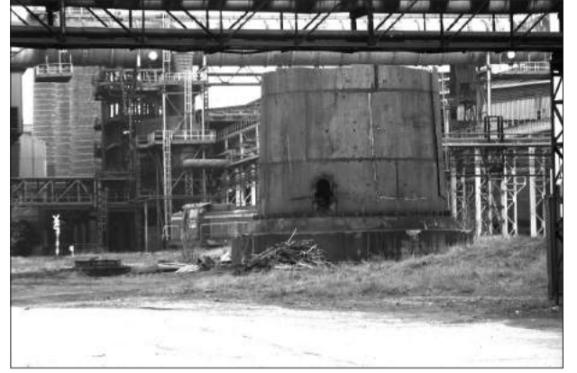
Już tylko niewielka część podstawy pozostała ze stumetrowego stalowego kominu obok Stalowni ISD Huty Częstochowa. Wkrótce zacznie się rozbiórka także trzech pobliskich kominów ceglanych.
