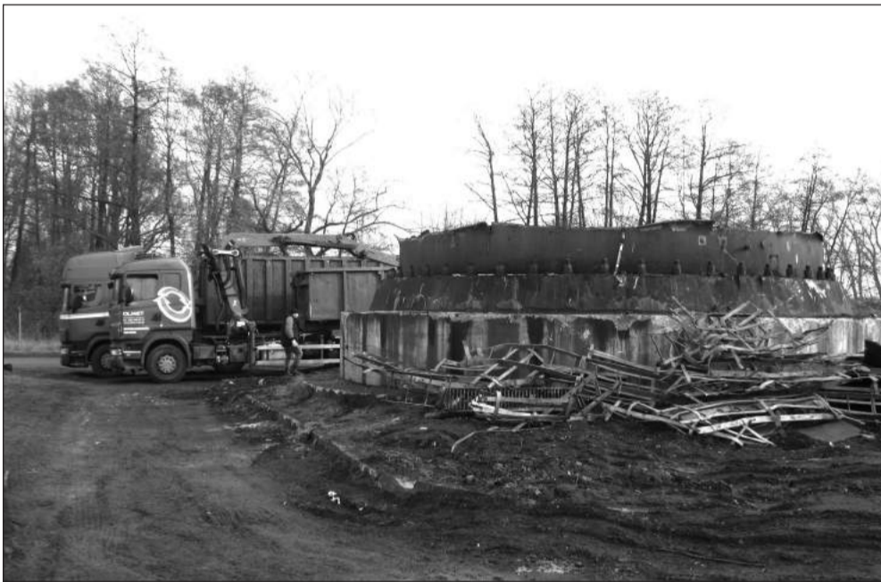
Ze stumetrowego stalowego kominu dawnej odpylni pozostał już tylko betonowy fundament.
